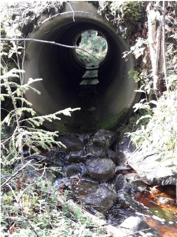
Kuva 26, kohta 18. Honkiojan esteellinen tierumpu.
